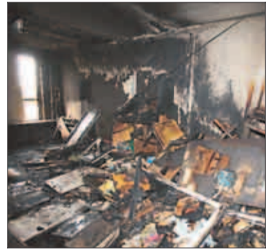
Nur Schutt und Asche: Eines der zerstörten Zimmer in der Hellersdorfer Kita
